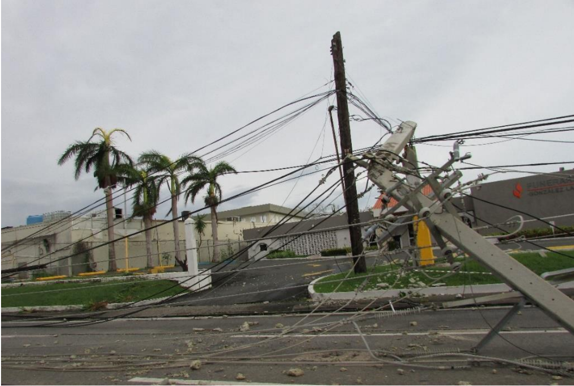
Figura 23 – Postes de distribución en madera y hormigón derribados en la Avenida 65 de Infantería, en Puerto Rico
