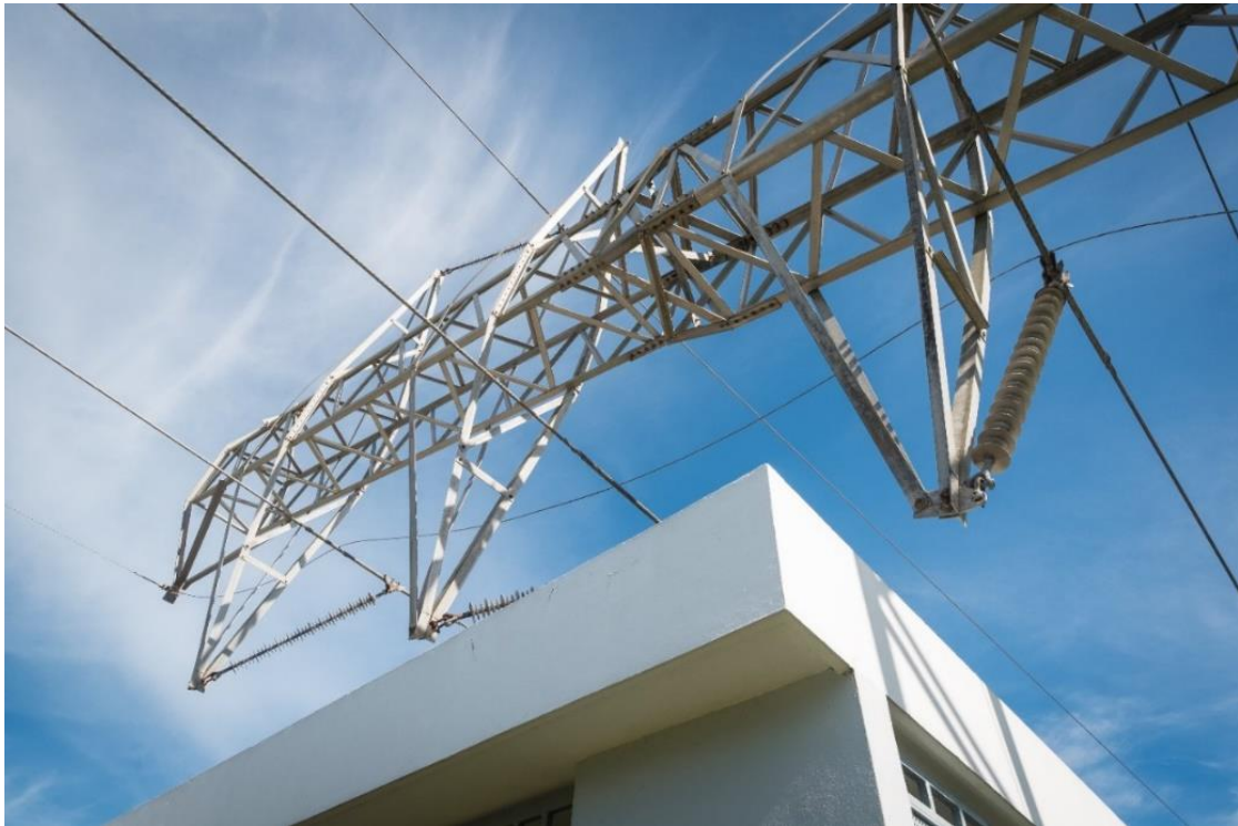
Figura 24 – Guaynabo, Puerto Rico – Líneas eléctricas continuaban cortadas y derribadas a lo largo de las carreteras y áreas residenciales casi tres meses después del huracán María
